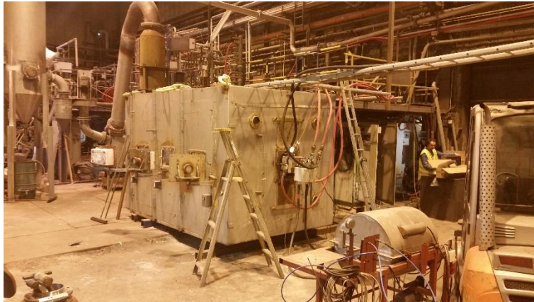
Figur 1. Kammarugn installerad i pilotanläggning.
