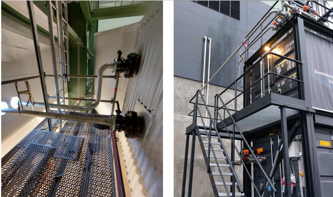
Figur 1 Vänster foto visar rökgasanslutningar på befintlig rökgaskanal. Höger foto visar rökgasanslutningar på utsidan av väggen till demonstrationsanläggningen.
