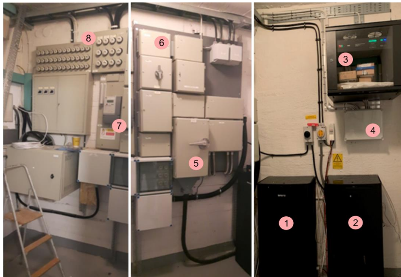
Figur 8. Tre bilder som visar eldistributionsrummet i hus 21 och där de centralaste komponenterna är numrerade och beskrivs i löptext.
