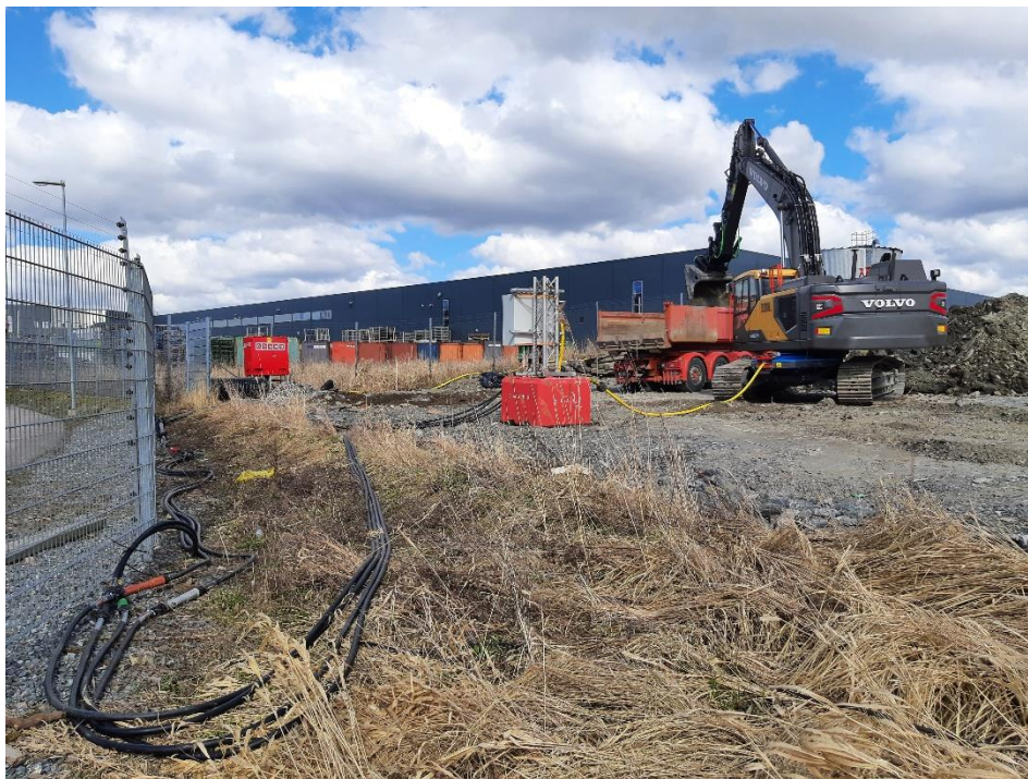
Figur 10 – Maskinsystemtest, inklusive energidistributionskedjan; temporärt elnät – distributionscentral – Power-Lock – kopplings-skåp – maskin.
