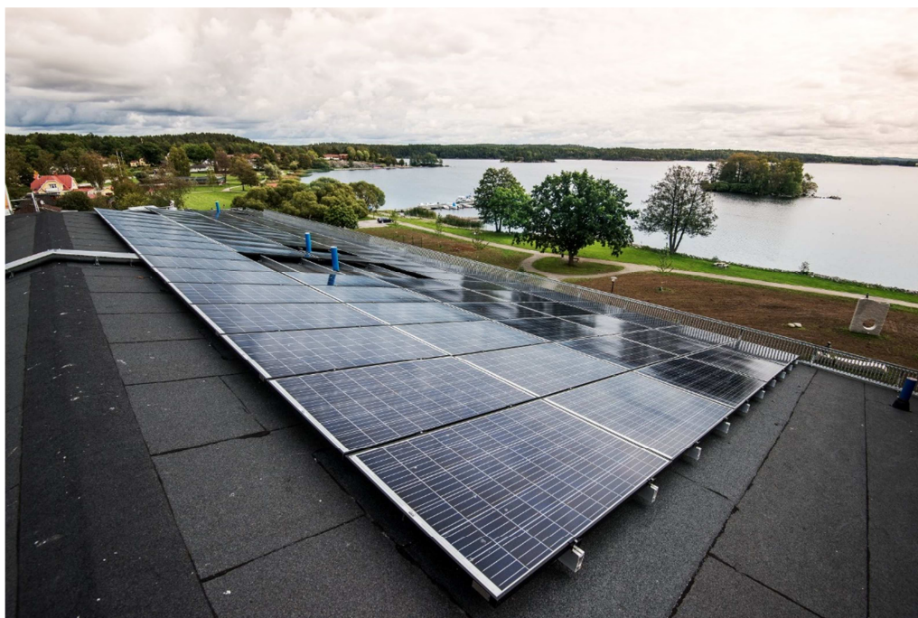
Bild 3 Del av solcellsanläggningen
