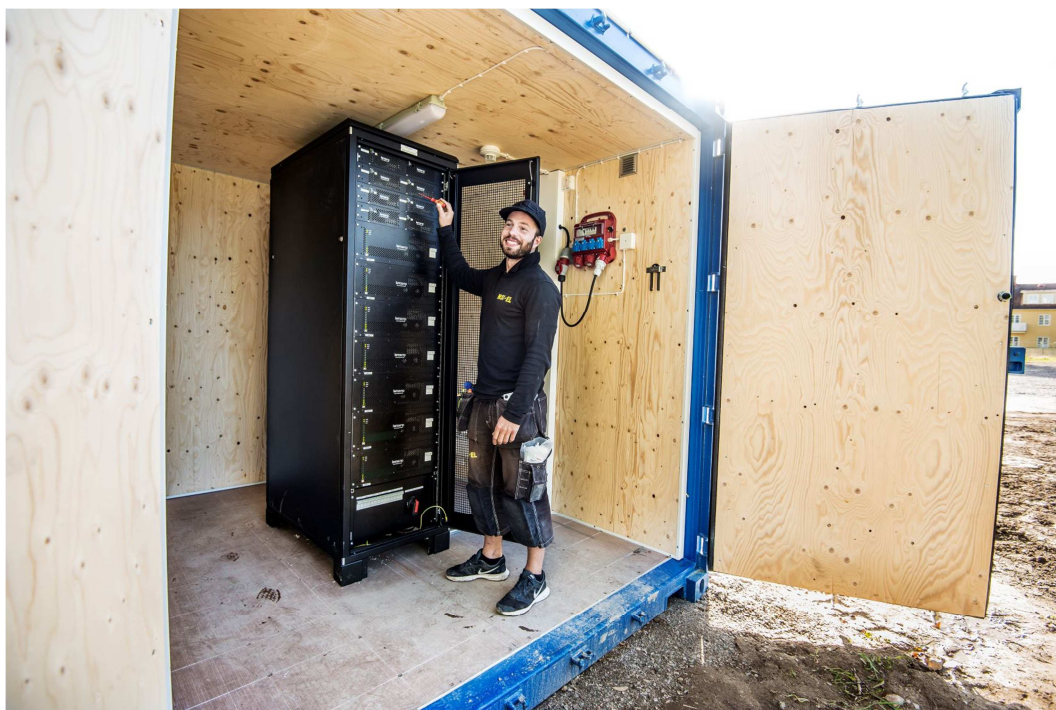
Bild 5 Batterilagret i sin container
