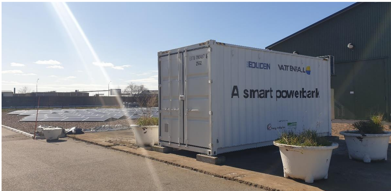
Figur 5. Batterisystemet på plats hos Boliden Bergsöe.
