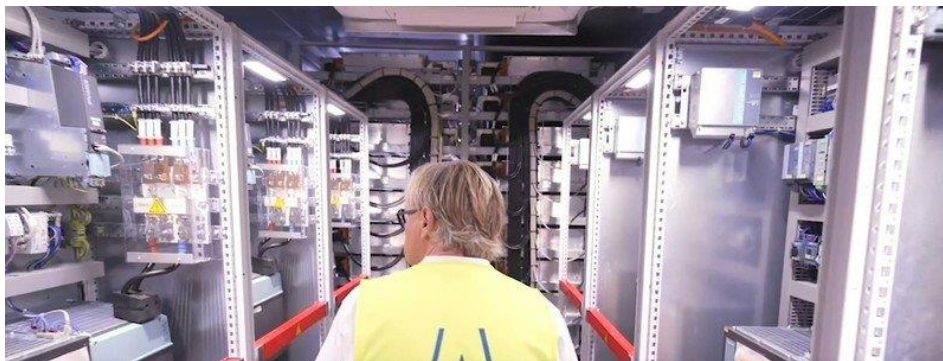
Figur 3. Insidan av battericontainern.
