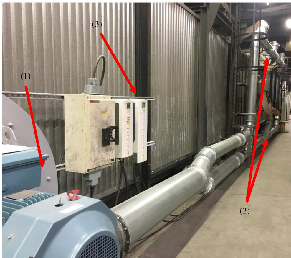
Figur 27 Bild över prototypanläggningens kylsystem: (1) Fläkt för matning av kylluft, (2) Kanaler till svaltunnelns fram och baksida, (3) frekvensreglering av kylluftfläkten och utsugsfläkten på taket.
